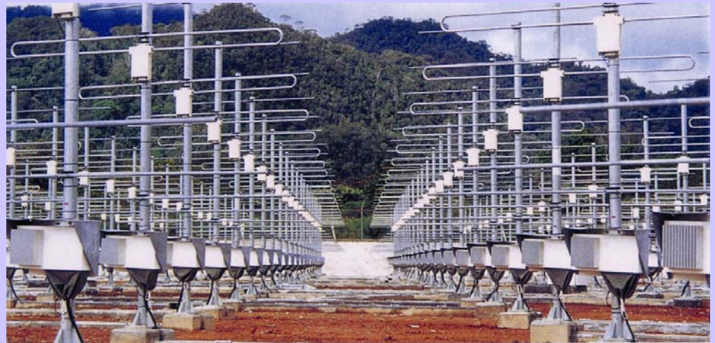
560 Yagi antennas, 100kW
